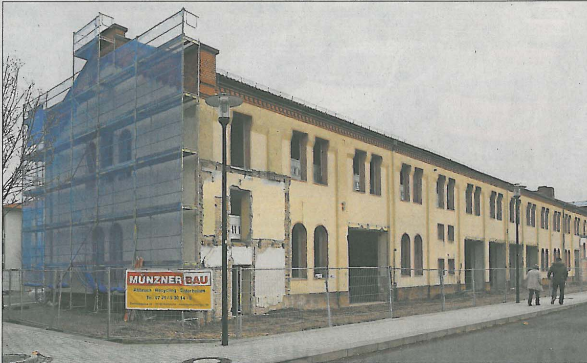
Erst waren es Pferde und Kutschen, später Motorfahrzeuge der Bundeswehr, die in der „Reithalle“ untergestellt waren. Ab nächstem Sommer soll es dort zehn schicke Wohnungen geben. FOTO: VAN
