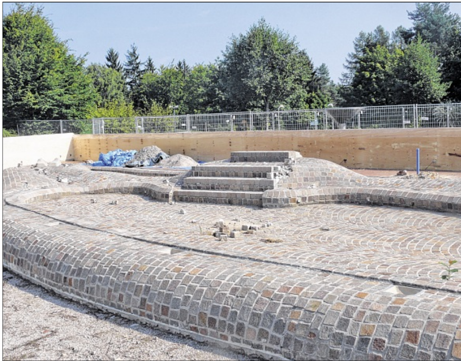
DAS ALTE UNDICHTHE PLANSCHBECKEN im Waldbad wird in den kommenden Wochen abgerissen.
