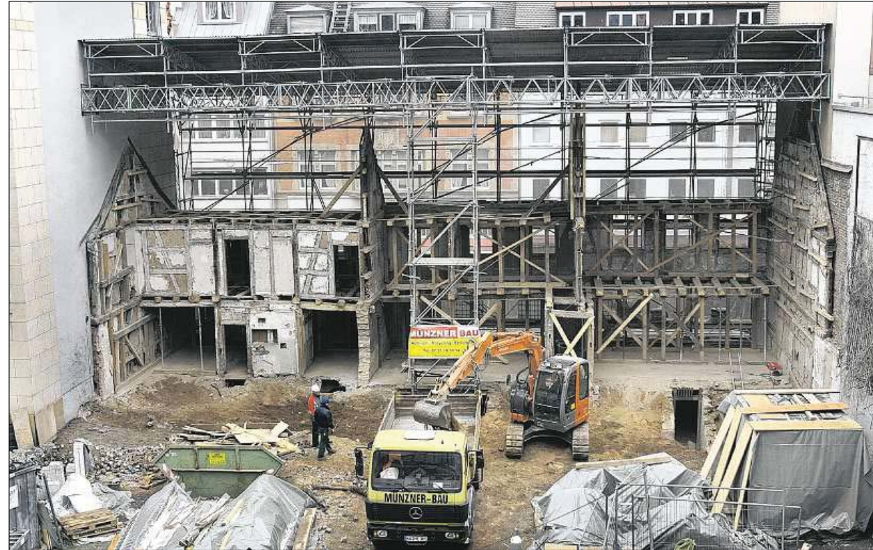
Die INSTANDSETZUNG der Modellhäuser in der Waldstraße hat begonnen. Nach dem Abbau der neueren Wände an der Hofseite ist der Blick ins Innere frei – und damit auf so manche marode Stelle der Fachwerk-Konstruktion. Derzeit wird der neue Keller unter dem Hof ausgehoben. Foto: jodo
