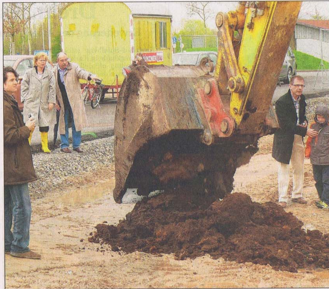
START FÜR BAUPROJEKT in Bruchhausen: OB Gabriela Büsselmeier kam zum Baggerbiss in das Gebiet „Am Sang“, wo neun Häuser für junge Familien entstehen. Foto: Weis
