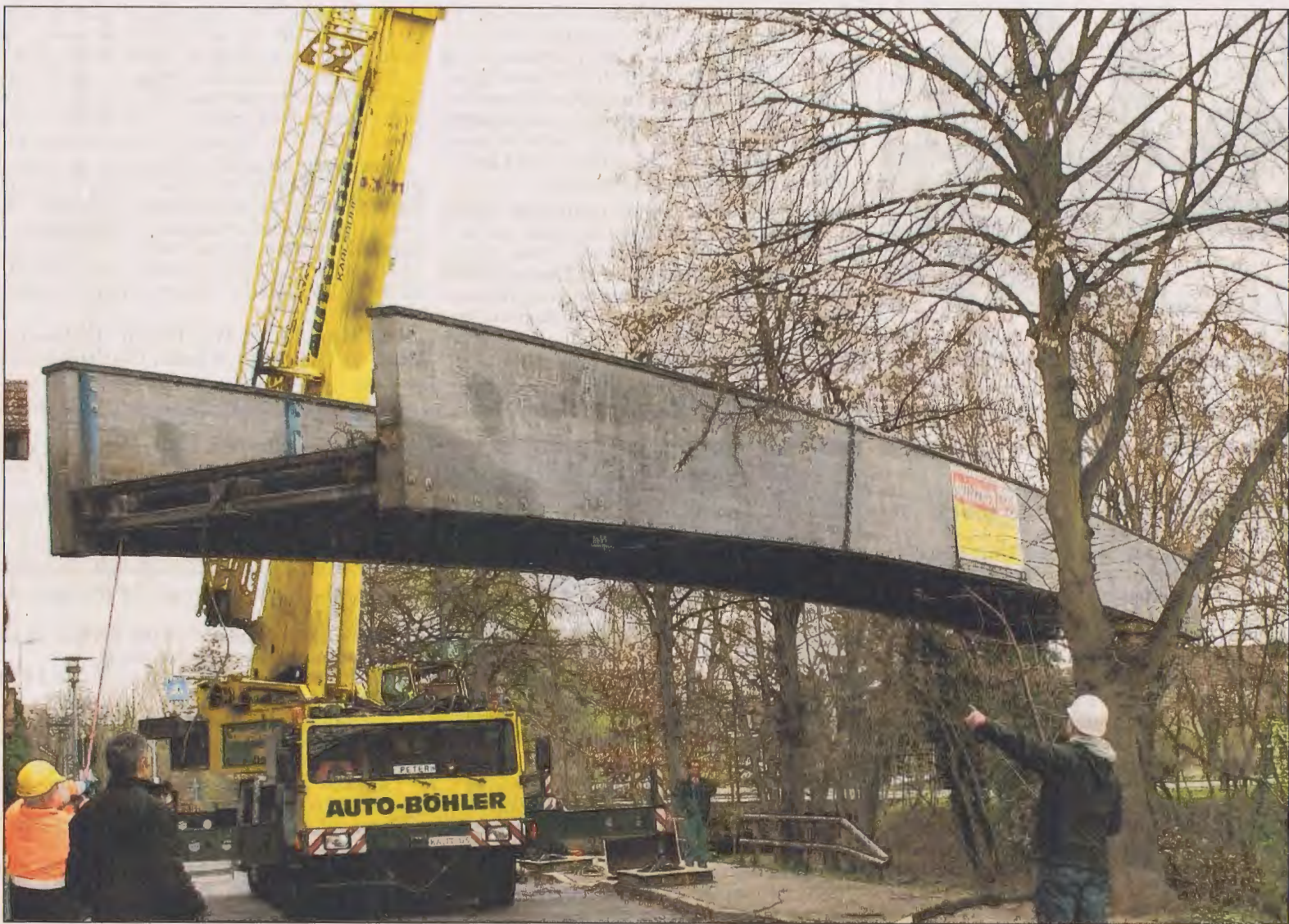
EIN BALANCEAKT war der Abbruch des Scheffelstegs in Ettlingen. Ein Spezialkran hob das 30 Jahre alte Bauwerk am Dienstag vorsichtig aus seiner Verankerung. Foto: pr
