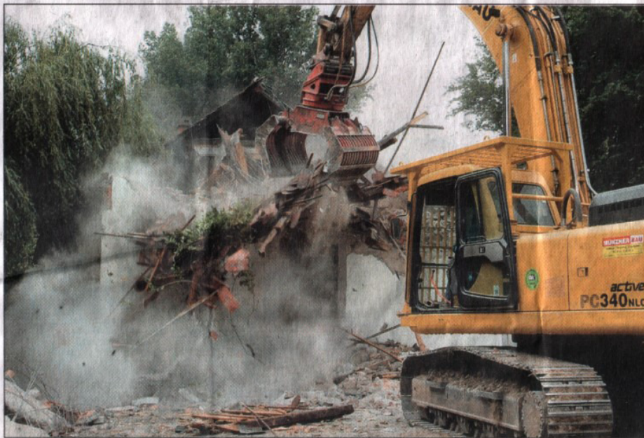
Ein Lebenswerk bricht zusammen: Auf der Kollerinsel begann gestern der Abriss der dort gelegenen Bauernhöfe der Familien Straub und Rupp.
