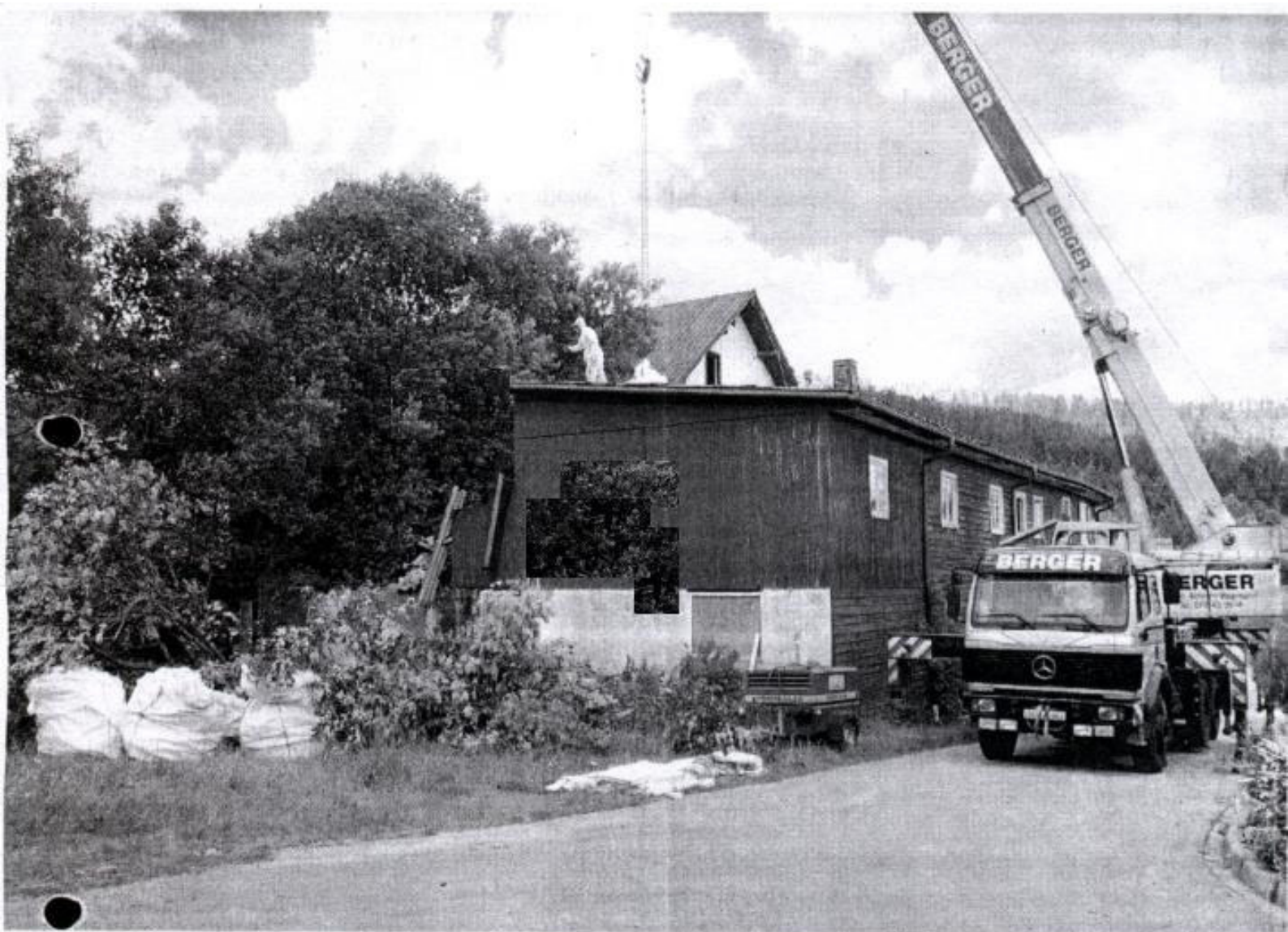
ABRISS MIT VERZÖGERUNGEN: In Schutzanzügen entfernten gestern Arbeiter an der Herrenwieser Kurhausruine asbesthaltiges Material. Heute soll der Bagger mit seiner Arbeit beginnen und das marode Gebäude dem Erdboden gleich machen. Foto: Margull
